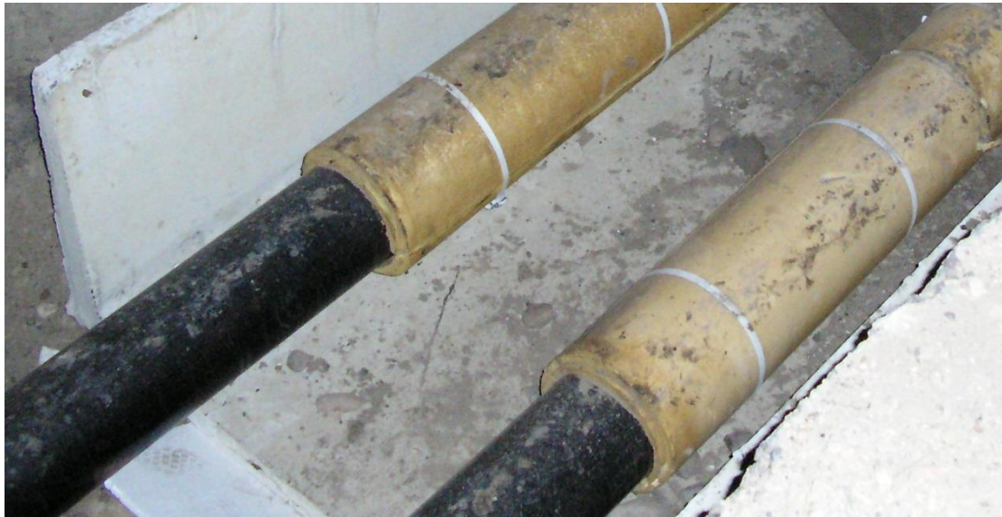
Трубопроводы отопления с изоляцией, канальная прокладка.
